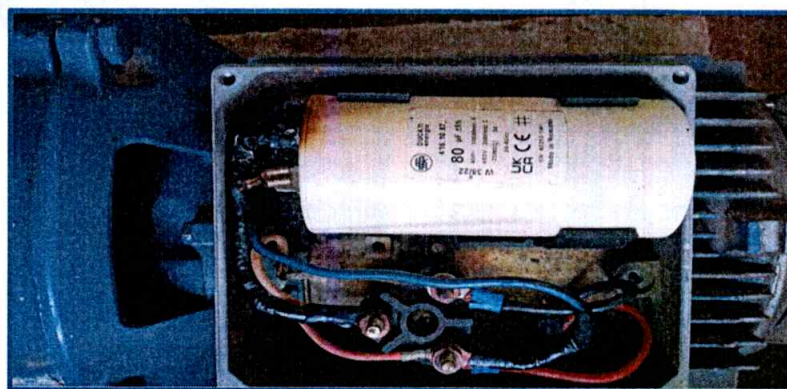
Foto No. 2: Componentes en mal estado bomba de agua.
