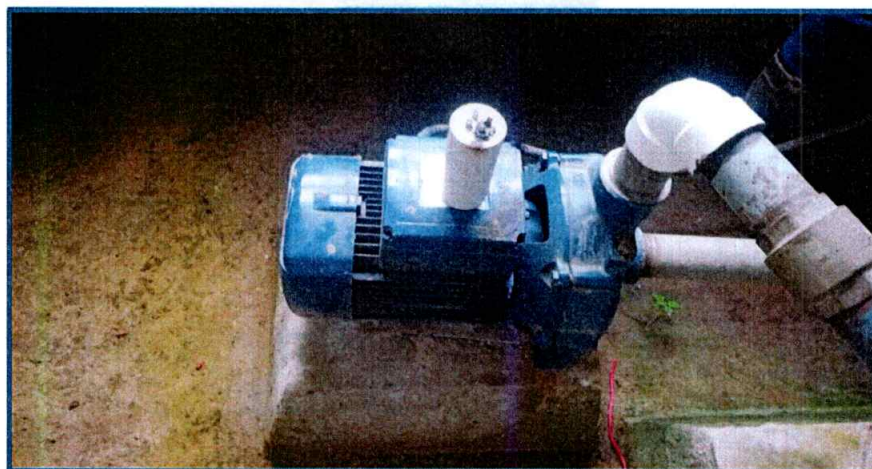
Foto No. 6: Bomba en mal estado.
