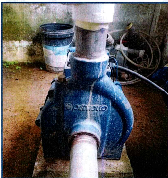
Foto No. 5: Entrada y Salida bomba 2".
